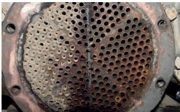
Abb. 2: Ablagerungen im Abgaswärmetauscher, hervorgerufen durch Schwefelwasserstoff im Brenngas, gewandelt in Schwefelsäure am Oxidationskatalysator, durch Verbrennungsprozesse im BHKW.
